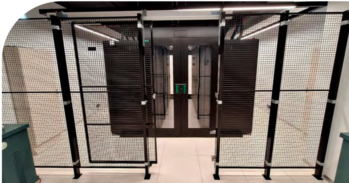
Armarios de alojamiento para servidores y equipos de comunicaciones del nuevo centro de procesamiento de datos
