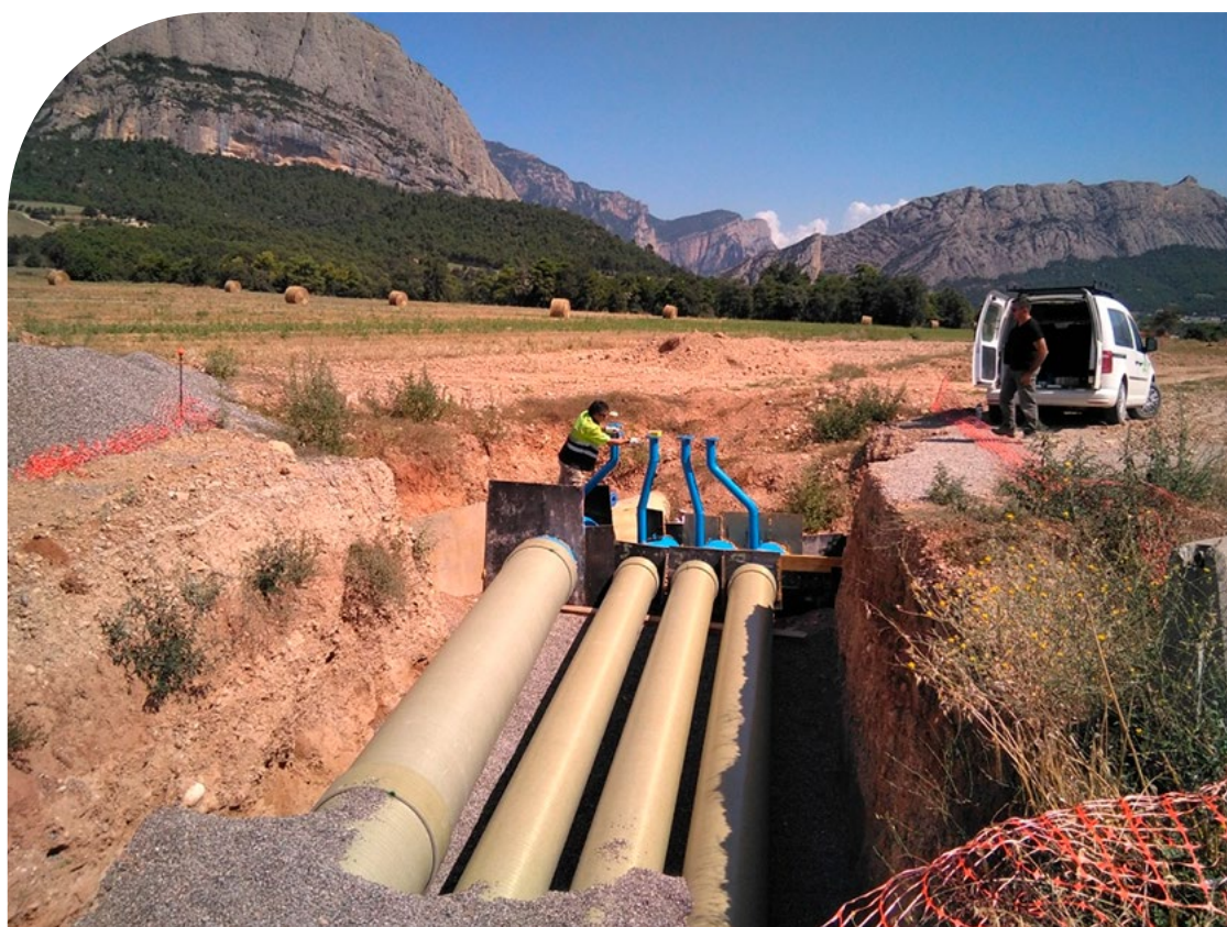
Tuberías de distribución
