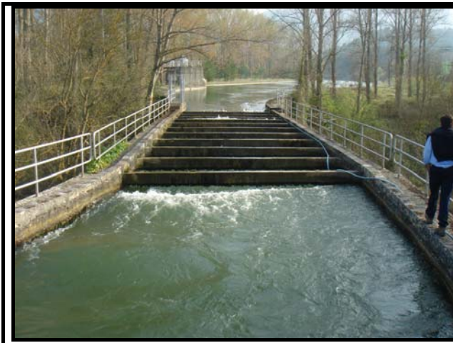
Obra de fábrica en el canal alimentador sobre la desembocadura del río Jerea en embalse de Cillaperlata
