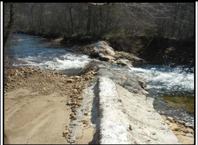
Azud de la toma de la piscifactoría de Busnela. Río Engaña
